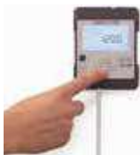
Controllo HMI su parete
